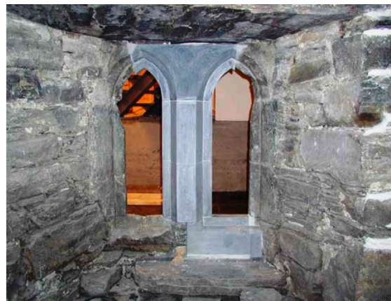
Figur 99: De restaurerte vinduskarmene i rom 007, sett mot 008. Vinduene er om lag en meter høye og 25cm brede. Det kan være et ombrukt vindu. Foto: © Ann Meeks, Arkeologisk museum, UiS i 2003. 602
